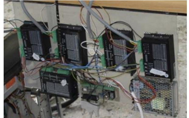
Şekil 9. Motor kontrol panosu
