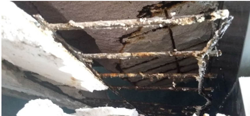
Şekil 4. 180 gün asit ortamında bekletilen donatılı gazbeton paneldeki korozyon
