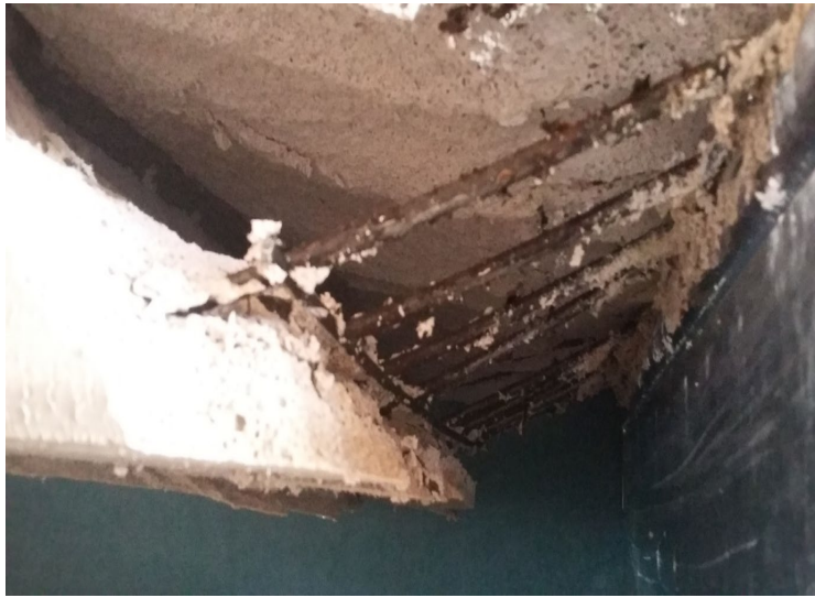
Şekil 7. 180 gün sülfat ortamında bekletilen donatılı gazbeton paneldeki korozyon
