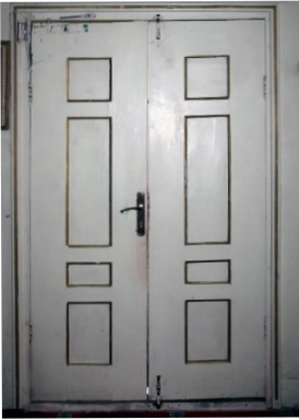
Fot. 13: Harim giriş kapısının iç yüzünün restorasyon öncesi
