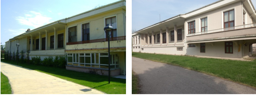
Fot.6: (sol)Kuzeybatı cephesindeki yıkılan eklenti kısmı (Sakarya Büyükşehir Belediye arşivi) ve (sağ) eklenti bölümünde tekrardan açığa çıkarılan kolonlar ve pencere açıklıkları (Yazarlar, 2022).
