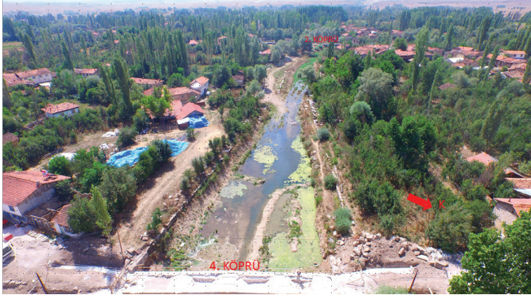
G. 7: Aizanoi Antik Kenti Penkalas Nehri ve Set Duvarları Restorasyon Öncesi (Aizanoi Kazı Arşivi, 2011-2020).
