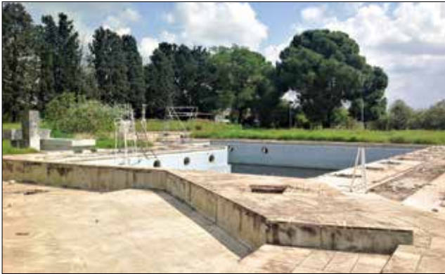
Fotoğraf 21. Havuzun metruk durumu (Yazarlar arşivi, 2014) / Abandoned situation of swimming pool
