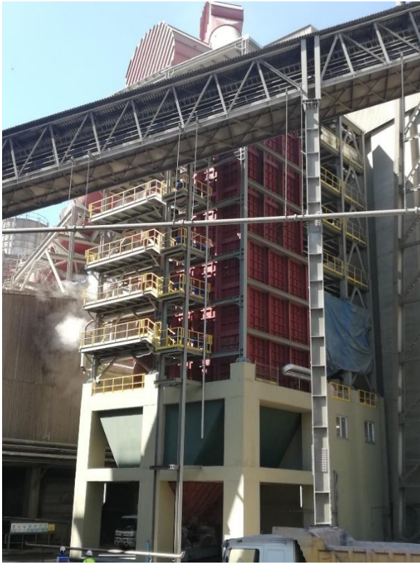
Şekil 5. Atık Isı Kazanı Tesis Görünümü (Figure 5. Waste Heat Boiler Plant View)
