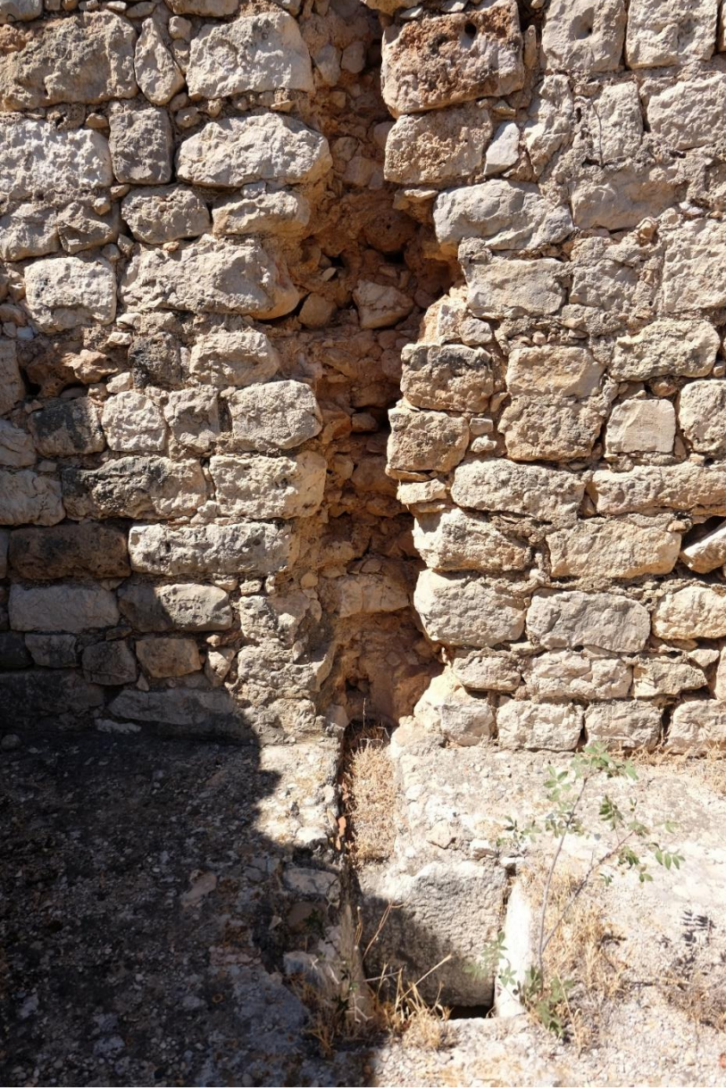
Foto 8: Mescit batı duvarında sarnıca künkler ile su aktarım sistemi
