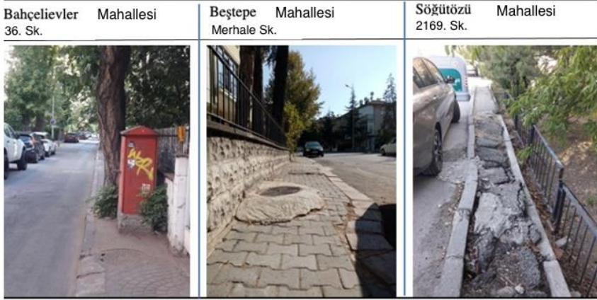
Şekil 3. Bahçelievler, Beştepe ve Söğütözü Mahallelerinde Kaldırım Genişliği Probleminin Örnek Görünümleri (Yazar, 2021; bu görsel yazar tarafından oluşturulmuştur).
