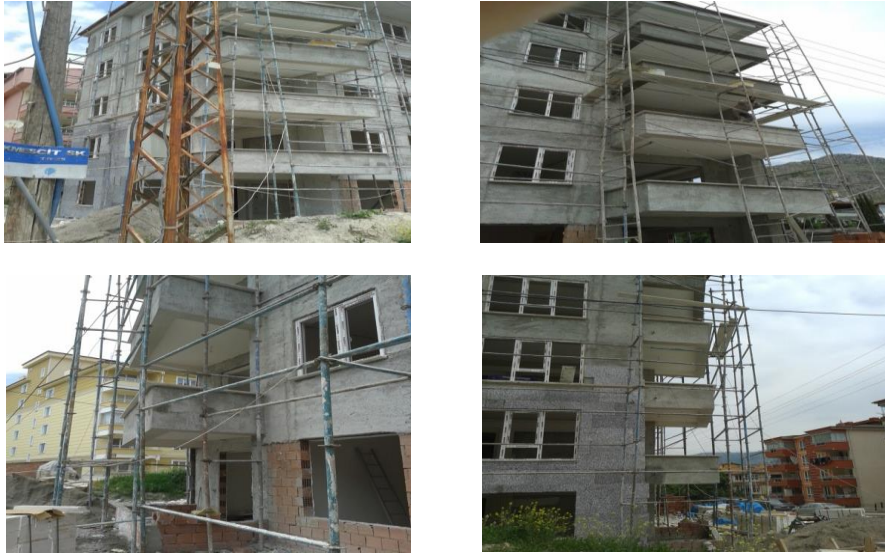
Şekil 7. Elektrik akımına kapılma riski (Figure 7. Risk of exposure to electric shock)
