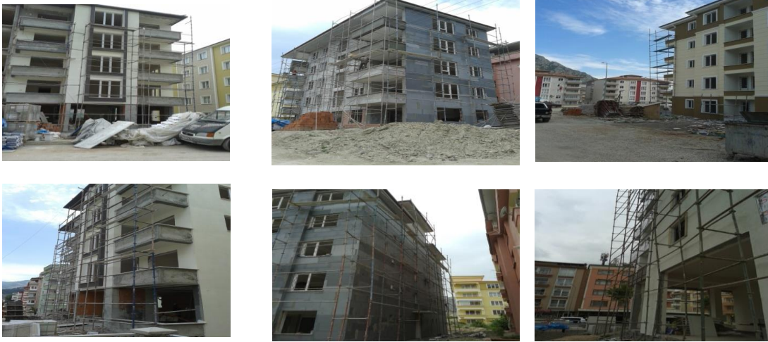
Şekil 5. Platformsuz ve merdivensiz iskele uygulaması (Figure 5. Scaffolding application without platform and stairs)
