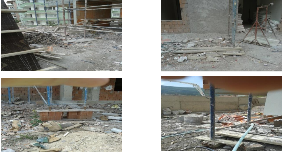
Şekil 8. İskele ve çevresi düzensiz (Figure 8. Scaffolding and surrounding area are improper)
