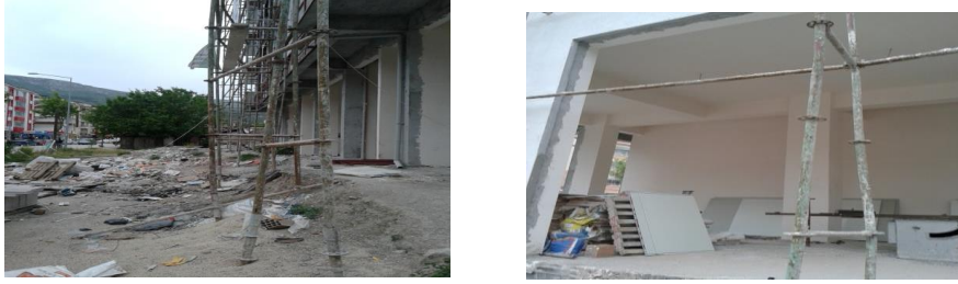
Şekil 6. İskele dik ve platformu düz değildir (Figure 6. Scaffolding is not upright and platform is not level)
