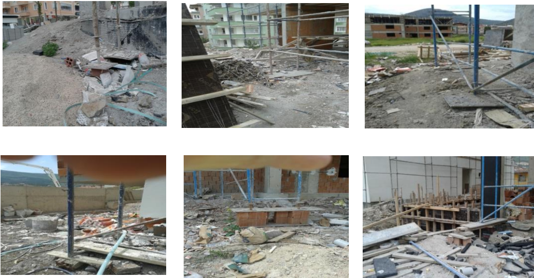
Şekil 3. Standartlara uygun olmayan iskele taban uygulaması (Figure 3. Non-Standard scaffolding base application)
