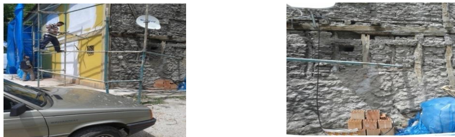
Şekil 4. Platform ve korkuluksuz ve doğru olmayan ankraj Sistemi (Figure 4.Improper anchoring system without platform and guardrails)
