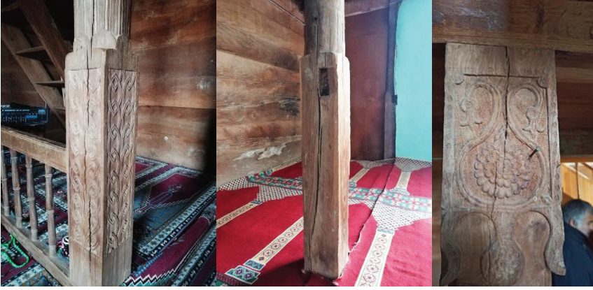
Fot. 17. Porsuk Camii'nde bulunan çatlaklar.
