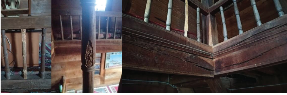
Fot. 16. Porsuk Camii ahşap korkuluklarında görülen hasarlar.
