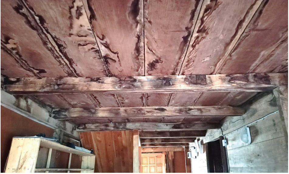
Fot. 14. Porsuk Camii iç duvarlarda eklenen elektrik kabloları ve ahşap tavanda görülen deformasyonlar.
