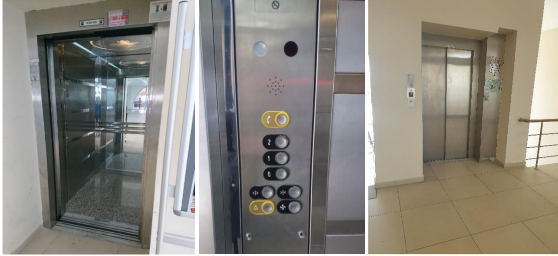
Şekil 17. Asansör girişi ve kontrol düğmeleri
