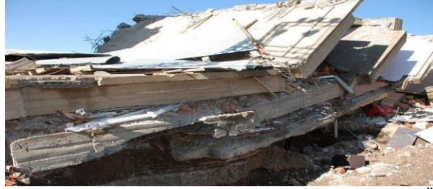
Şekil 58. Bodrumsuz Yapıda Hasar, Tekil/Sürekli Temel Sistemi Örneği (URL-9)
