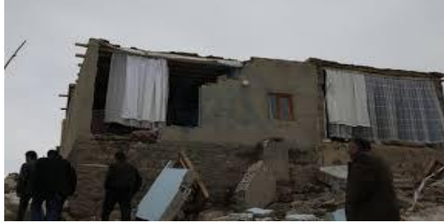
Şekil 71. Van Gedikbulak Köyü, Briket Evde Deprem Hasarı (URL-11)
