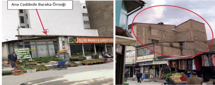
Şekil 43,44. Bahçivan Mahallesi Hacı Osman Camii Civarı Plansız Riskli Yapı Örnekleri, 2022 Yılı
