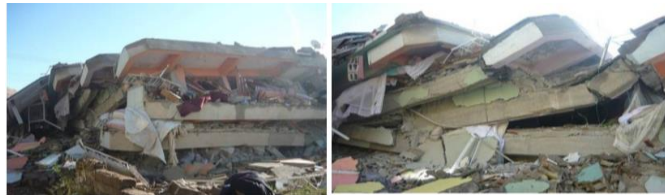
Şekil 56,57. Yanal ötelenme ve burkulma hasarı ile çökme mekanizması oluşmuş yapı örneği (URL-9)
