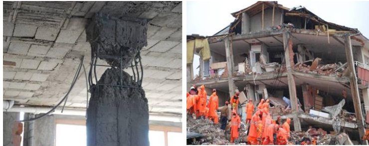
Şekil 63,64. Van Kent Merkezi Yetersiz Sargı Donatısı, Asmolen Döşeme Ağır Malzeme ile Cephe Kaplamalı Ağır Bina Örnekleri
