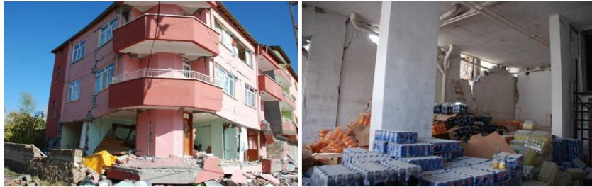
Şekil 67,68. Yapılarda Tasarım Hatalarına Örnek (Van-Erciş)
