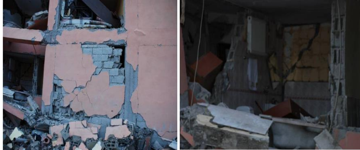
Şekil 65,66. Dolgu Duvar Hasarları (URL-9)
