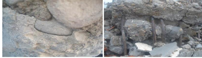
Şekil 54,55. Çimento Hamuru-Agrega Ara Yüz Çatlağı ve Betondan Sıyrılan Düz İnşaat Demiri
