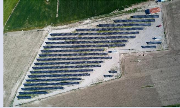
Resim 1. 1 MW güneş enerji santrali
