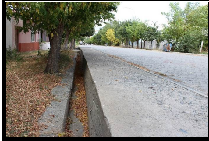
Fotoğraf 2. Kağızman'da yol kenarı su kanalları.
