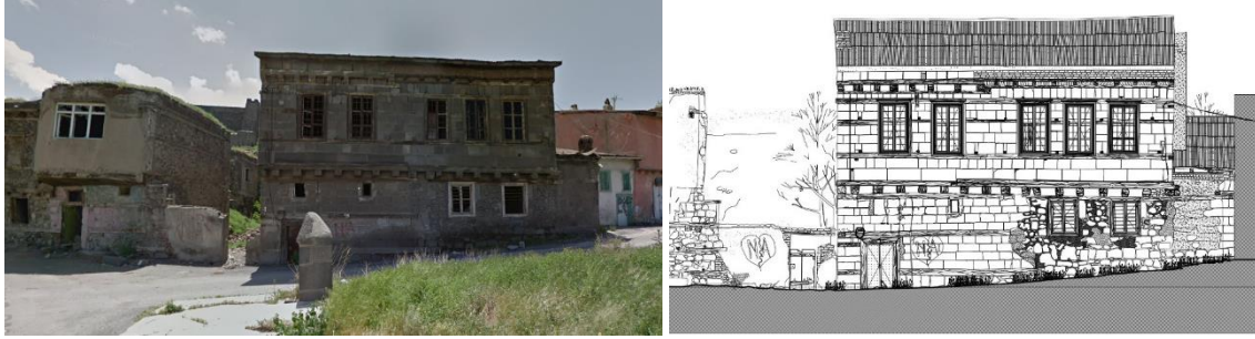
Şekil 1. Feyzullah Efendi Konağı'nın Orijinal Haline Ait Kuzey Cephesi Rölöve Çizimi ve Fotoğrafı (Google Map, 2015; EBB, 2022)
