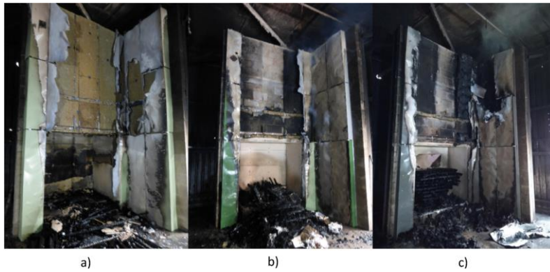
Şekil 12. Deneylerden sonra cephe durumları a) ACM-A2+MW, b) ACM-A2+PF, c) ACM-A2+PIR [Jones vd., 2021].
