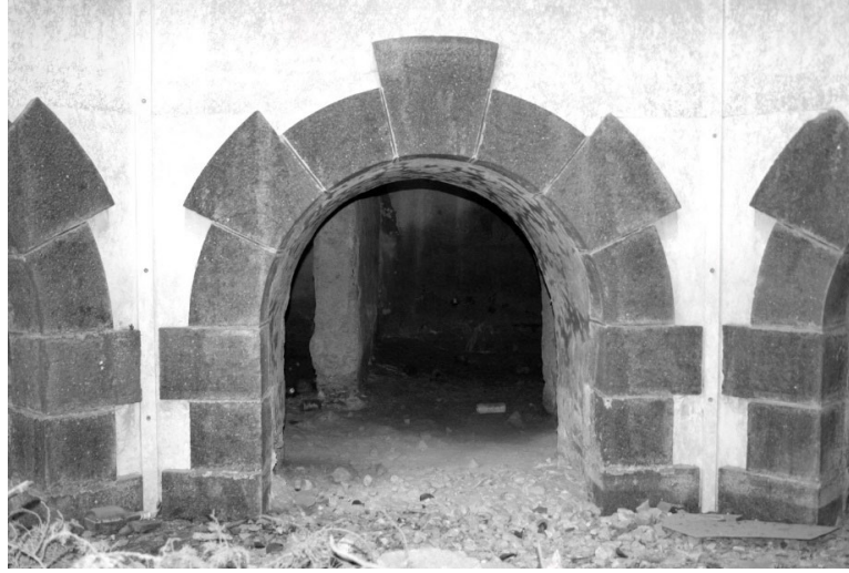
Şekil 18. Su Dağıtım Yapısı, Zemin Altı Yapısı -6.88 kotu tek açıklıklı yarım daire profilli kemer (Özlen, 2006)
