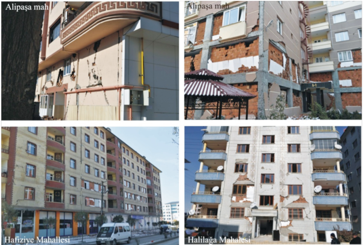
Şekil 10. Hasar derecesinin yüksek olduğu mahallelerden görünüm.
