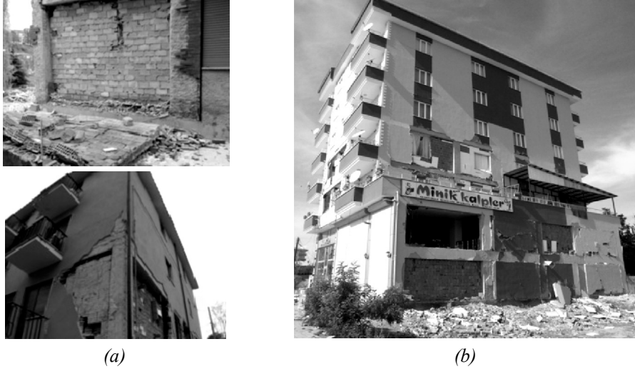
Şekil 2. (a) L'Aquila [4], (b) Van depremi alt ve orta katların sandviç duvar hasarları.
