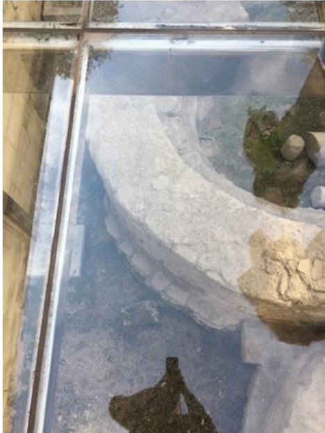
G. 22: Cam döşeme malzemesindeki korozyonlar (Neşe Karaçay, 2018)
