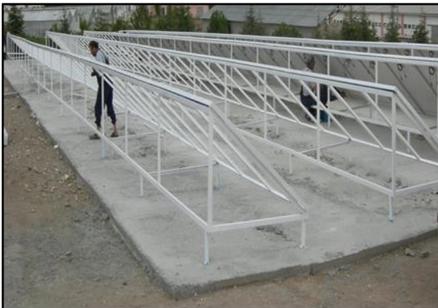
Şekil 10. PV Panel Taşıyıcı Konstrüksiyon Kurulumu Şekil 10'deki görselde görüldüğü gibi; PV paneller sabit (38°) eğimli, yerden 30 cm yükseklikte monte edilmiştir.
