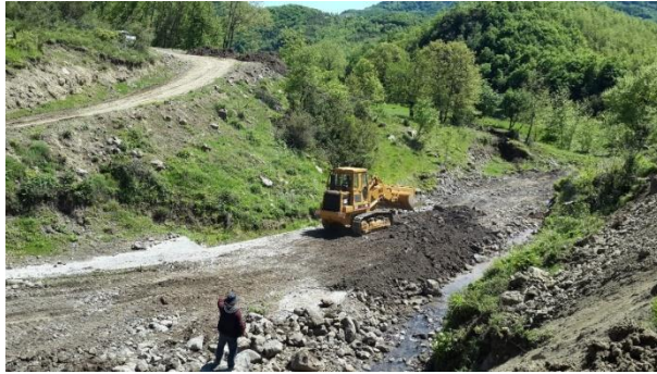
Şekil 7. Kutu menfezin inşa edileceği zeminin düzeltilmesi (Leveling the ground on which the box culvert will be constructed)
