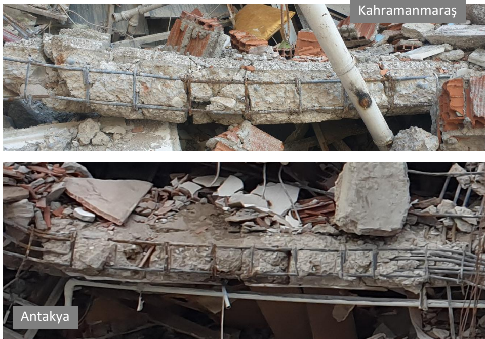
Şekil 14. Yıkılan bazı binalardaki yapısal elemanlarında sarılma bölgesi bulunmaması
