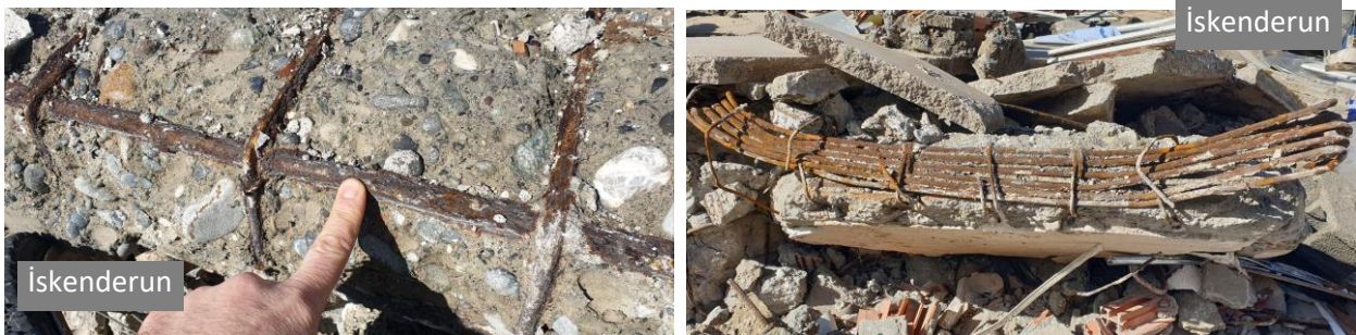
a) Donatının aşırı korozyonu
