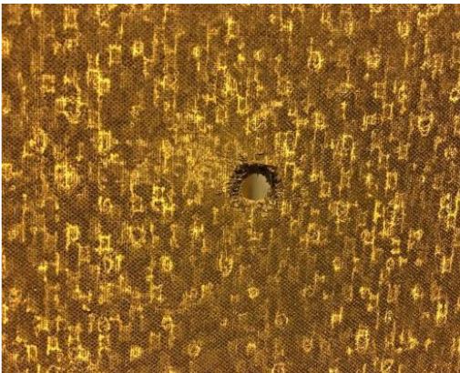
Şekil 12: Hasarlı bölgenin görüntüsü
