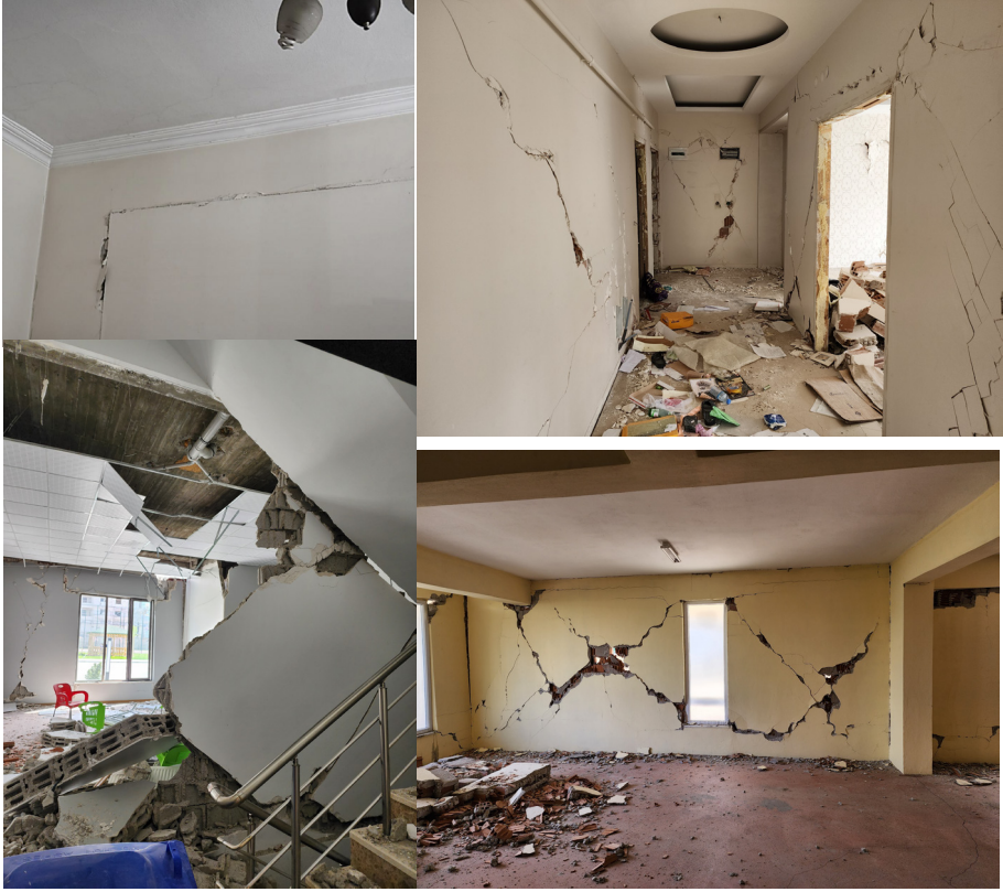
Şekil 6. Dolgu duvar hasarı
