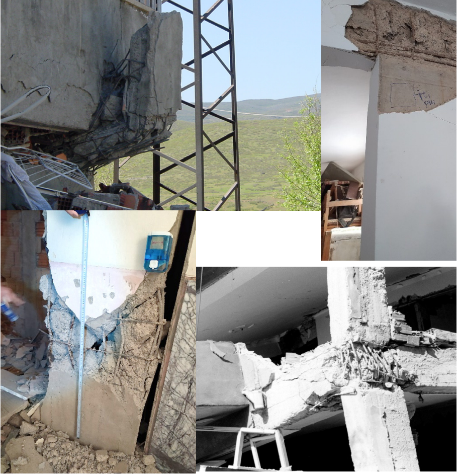
Şekil 3. Yetersiz sargı ve detaylandırma sonucu oluşan tipik hasarlar
