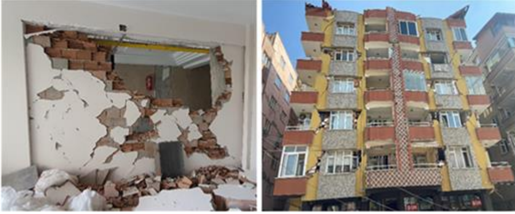
Şekil 17. Dolgu duvarlarda oluşan hasarlar
