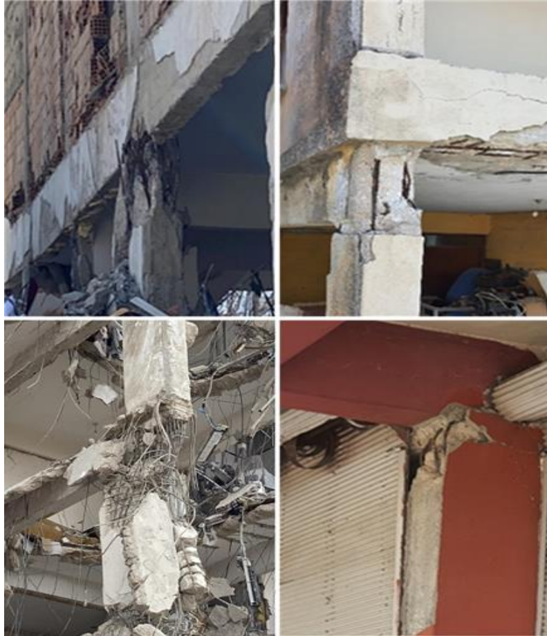
Şekil 11. Kolon ve kiriş uçlarında ve birleşim bölgelerinde oluşan hasarlar
