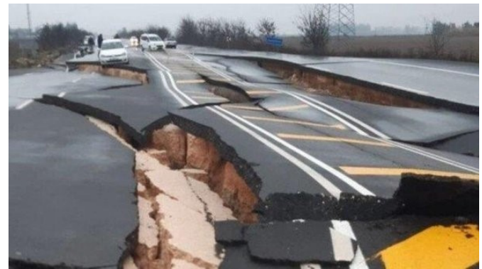
Fotoğraf 1. Deprem nedeniyle otoyolda devasa yarıkların oluşması (A Haber, 2023).
