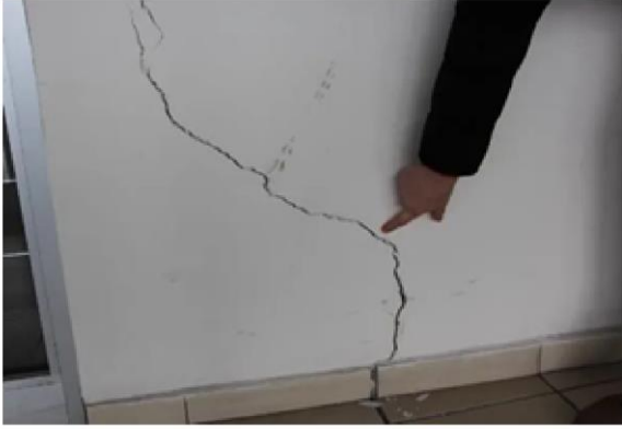
Şekil 2. Yerel gazetede yayınlanan, Samsun 19 Mayıs stadyumu yapısında oluşan çatlaklar ve açılmaları gösteren fotoğraflar (URL-1)
