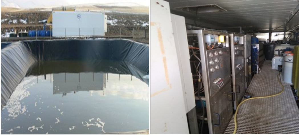
Şekil 1. Sızıntı suyu toplama havuzu ve arıtma tesisi dış ve iç görüntüsü
