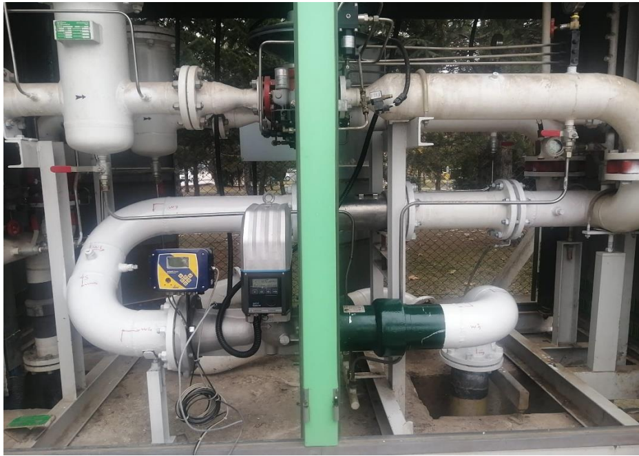
Şekil 2. Bölge regülatörünün revizyon sonrası hali
