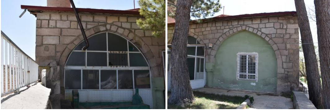
Şekil 17. Kuzey Cephesindeki Duvarda Bozulmalar, 2022
