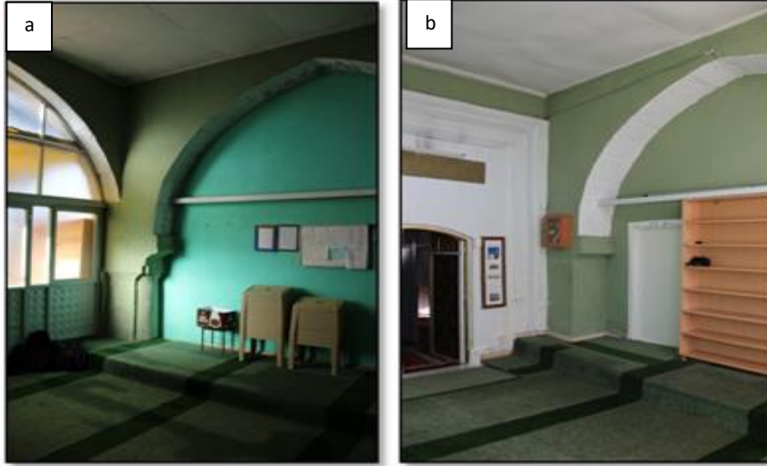
Şekil 22. Son Cemaat Bölümünde, Doğu (a) ve Batıda (b) Kapatılan Duvarlar ve Gergi Çubukları, 2020
