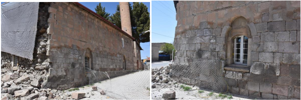
Şekil 16. Doğu Cephesindeki Duvarda Bozulmalar, 2022
