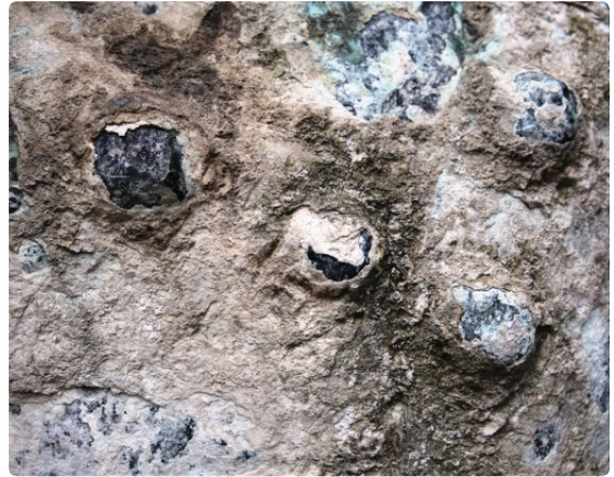
Resim 44. Topsy Tekke Hamamı külhan kazanı iç yüzünden çivi perçin ayrıntısı (altta); yüzey suyun bıraktığı kireçli tortuyla kaplı.
