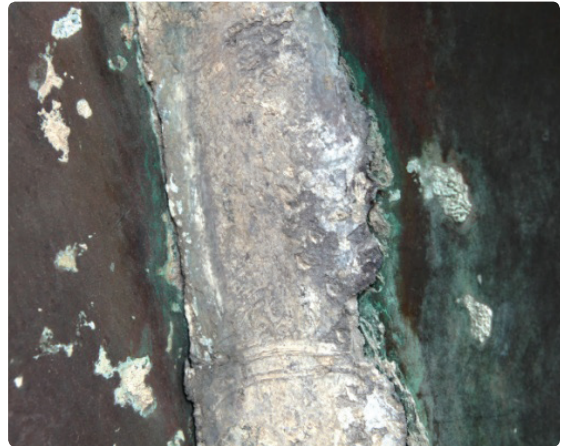
Resim 17. Kastamonu Vakıf Hamamı külhan kazanı iç taban kenarında perçinli kesim üzerindeki kurşun lehim (iç yüz).
