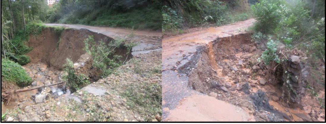
Fotoğraf 1-2: Anbarlı köyünde yol kenarında meydana gelen iki ayrı heyelan
