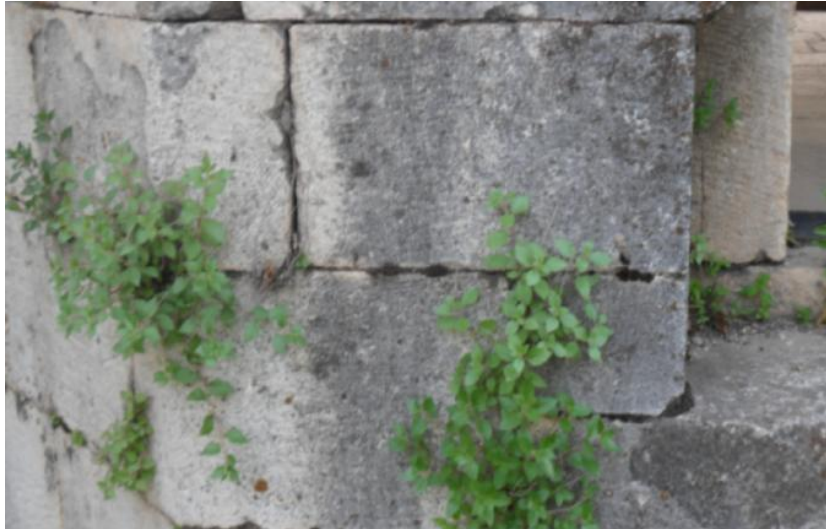
Şekil 16. Uzun Hasan Türbesi duvarlarında derzlerde gelişen bitki örtüsü
