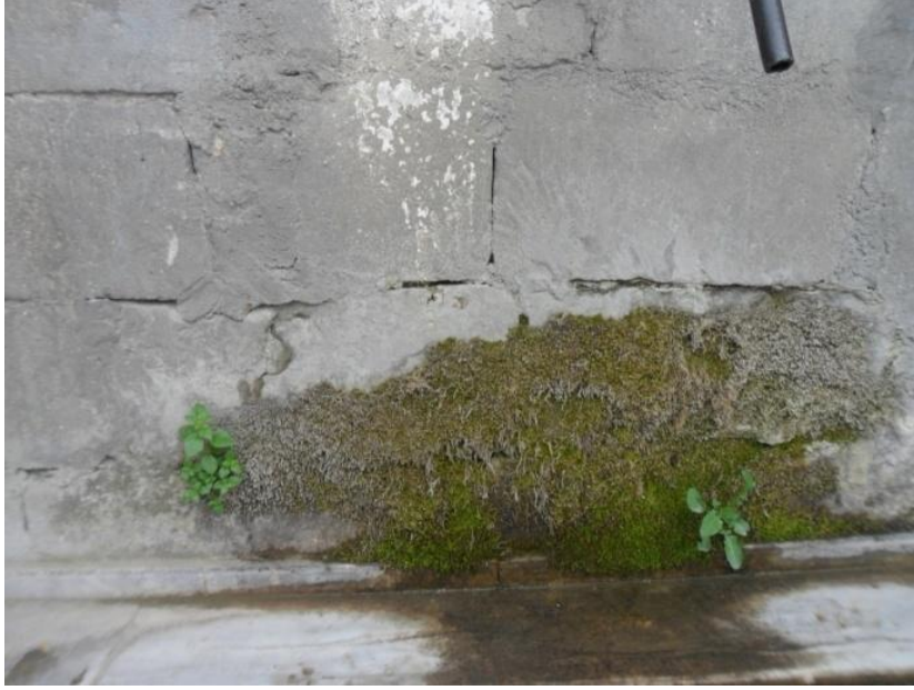
Şekil 6. Çemişgezek Baş Çeşmesi alt duvarlarında nemden dolayı gelişen yosunlar.
