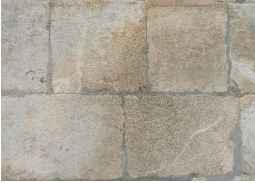
Şekil 4. Süleymaniye Camii derzlerinde çimento kullanımı
