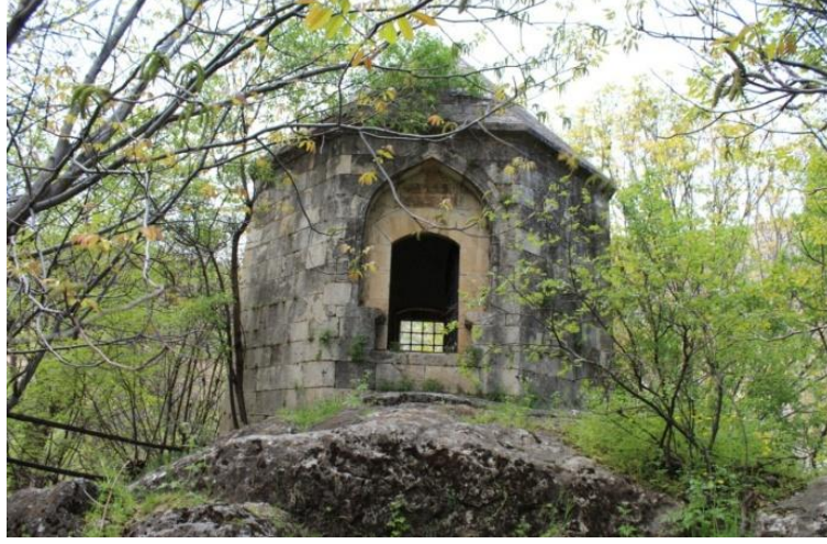
Şekil 12. Çemişgezek Uzun Hasan Türbesi duvarlarındaki kararma
