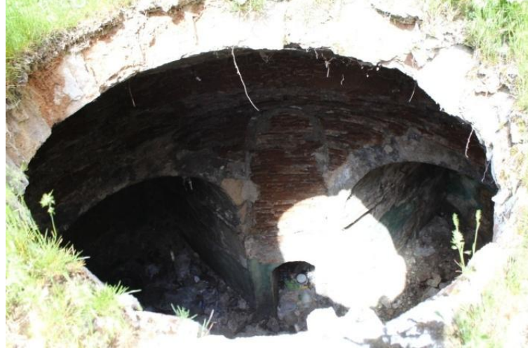
Şekil 13. Yeni Hamam da gözlenen, yapının terk edilmesinde dolayı tavan çökmesi
