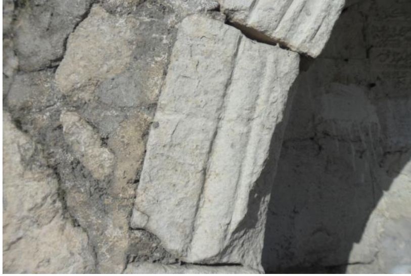
Şekil 10. Çukur Çeşme de Sızan sulardan kaynaklı parça kopması
