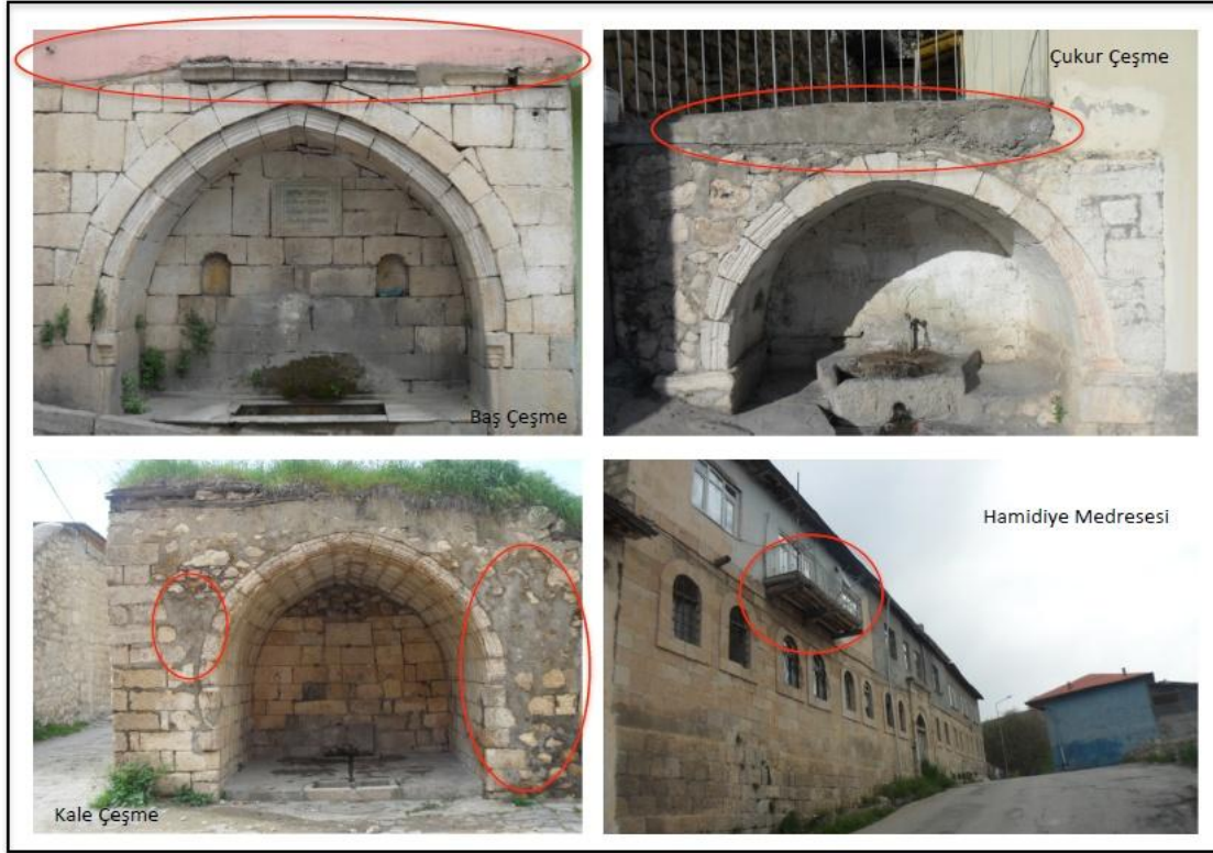
Şekil 3. Çemişgezek kent içindeki bazı tarihi yapılarda gözlenen bilinçsiz onarımlar
