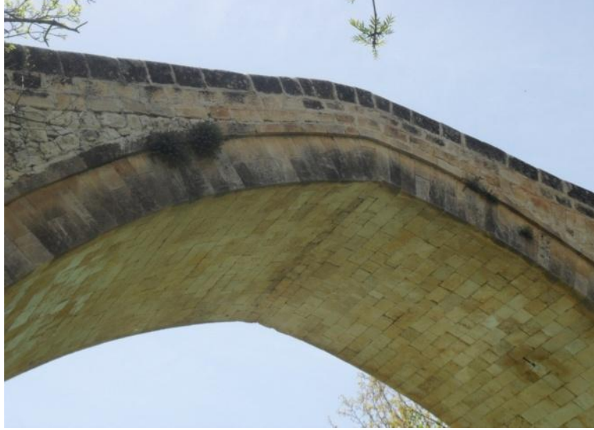
Şekil 15. Tahar (Yusuf Ziya Paşa) Köprüsünde atmosferik kirlenmeden kaynaklanan patina tabakası
