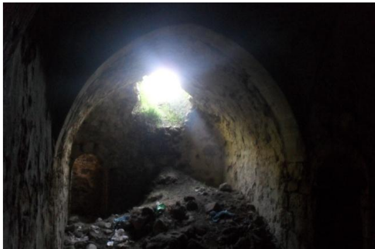
Şekil 14. Atik Hamam da gözlenen, yapının artık kullanılmamasından ve çatıdaki toprak birikiminin oluşturduğu tavan çökmesi
