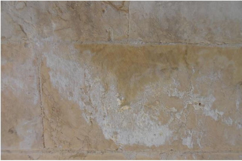
Şekil 7. Yelmaniye Camiinde tuz etkisiyle meydana gelen çiçeklenme
