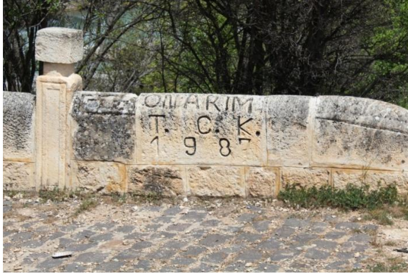
Şekil 11. Tahar (Yusuf Ziya Paşa) Köprüsü taşlarında gözlenen kararma. (Bu arada onarımla ilgili bilginin abartılı bir şekilde sunulması gözlerden kaçmamaktadır.)
