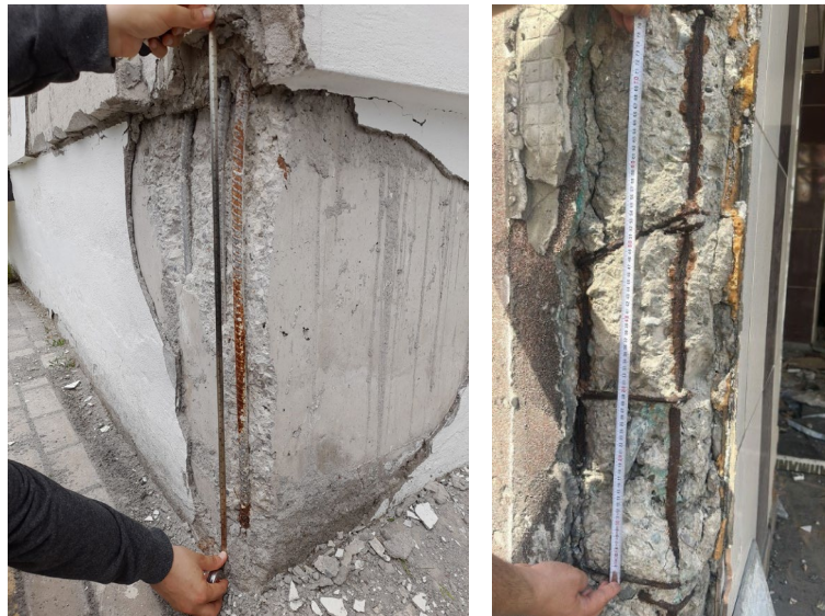
Şekil 6: Betonarme elemanlarda yetersiz etriye aralığı Figure 6: Inadequate spacing of stirrups in reinforced concrete elements
