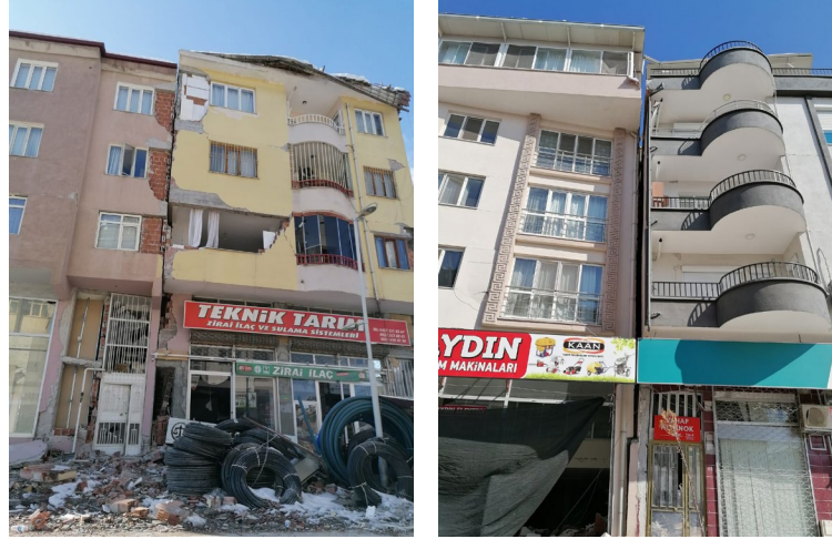
Şekil 5: Çekişleme etkisiyle betonarme binalarda oluşan hasarlar Figure 5: Damage occurring in reinforced concrete buildings due to the impact of hammering
