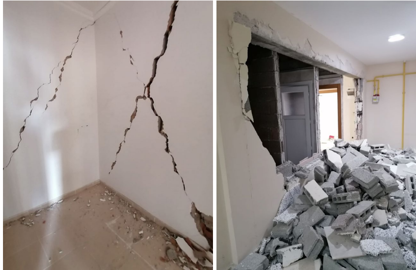
Şekil 14: Dolgu duvar hasarları Figure 14: Damage to infill walls
