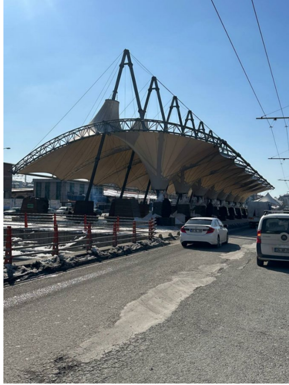
Şekil 19: Şemsiye biçimli çelik yapının genel görünümü (38.35250° K, 38.31651° D) Figure 19: General view of the umbrella-shaped steel structure (38.35250° N, 38.31651° E)
