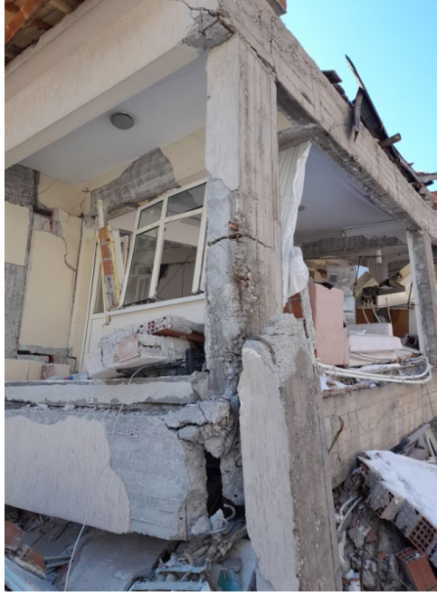
Şekil 8: Güçlü kiriş-zayıf kolon nedeniyle hasar alan binalar Figure 8: Buildings damaged due to strong beam-weak column design
