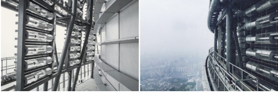
Şekil 10. Kulede bulunan rüzgâr türbinleri (Kaynak: https://www.architectural-review.com/today/up-the-632m-shanghai-tower-by-gensler-second-tallest-in-the-world )
