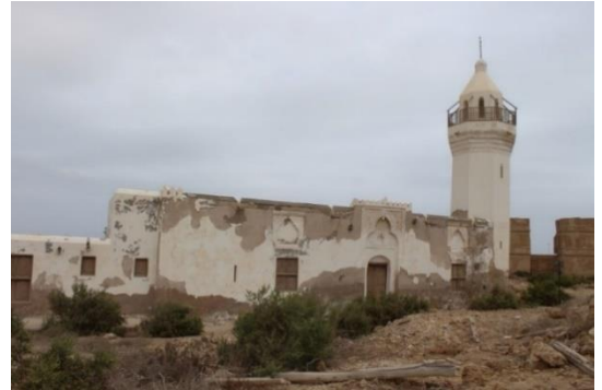
Fotoğraf 15d. Şafî Camii, batı cephe, rüzgâr boya dökülmüştür (Şubat 2022)
