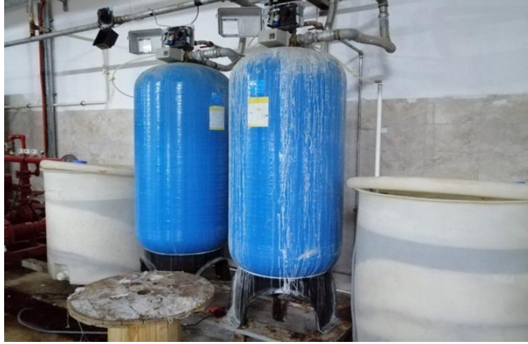
Şekil 9. Su Yumuşatma Cihazı (İyon Değiştirici) (Water Softening Device (Ion Exchanger))
