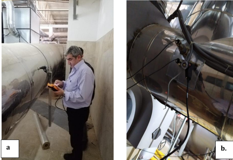
Şekil 3. Baca Gazı Analizörü İle Bacadan Numune Alımı a. Isı Merkezindeki Kazandan Numune Alımı, b. Yüzme Havuzundaki Kazandan Numune Alımı (Sampling from Chimney with Flue Gas Analyzer a. Sampling from Heat Center Boiler, b. Sampling from Swimming Pool Boiler)
