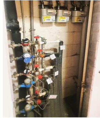
Şekil 15. İç Sıvası ve Yalıtımı Yapılmamış Tesisat Bacası
