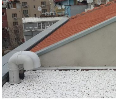
Şekil 19. Çatı Kotunda Tesisat Bacası Havadanlığı
