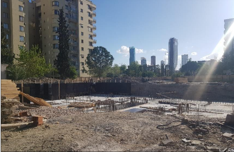
Şekil 12. Kentsel dönüşüm sürecini tamamlamayı bekleyen yıkılan hasarlı yapı (Yazar Görgülü tarafından çekilmiştir, 2023)
