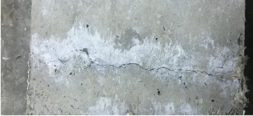
Şekil 6. Basınç testi sırasında küp numunelerinin arasındaki setler boyunca meydana gelen çatlaklar
