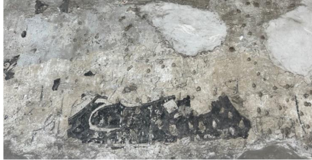
Resim 55: Son cemaat yeri beden duvarında kalem işinden yazı kalıntılarının detay.
