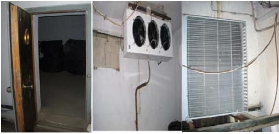
Şekil 2. Soğuk Oda Kapısı, Evaporatör ve Soğutma Grubu
