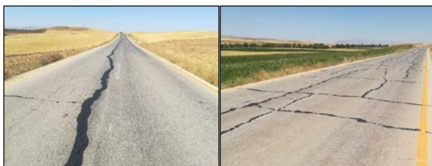
Şekil 5. Sahada gözlemlenen mevcut SSB yola ait çatlak
