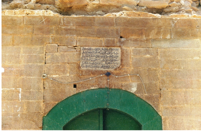
Fig. 12. Restorasyon sırasında giriş kapının durumu 36
