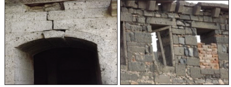
Şekil 7 Surp Sargis Kilisesi'nde meydana gelen eksen kaymasına bağlı hasarlar
