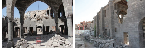
Şekil 14. Ermeni Katolik Kilisesinde çöken üst örtü ve kısmi duvar yıkılmaları
