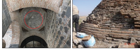
Şekil 9. Saint George Kilisesi'nin kubbesinde meydana gelen nem sorunları ve beton dam yapımı
