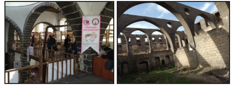
Şekil 12. Protestan ve Surp Sargis Kilisesinde kullanıcı kaynaklı taşıyıcı sistem hasarları
