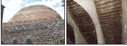
Şekil 4. Saint George kilisesi kubbesinde meydana gelen bitkilenme, Mar Petyum kilisesindeki betonarme damın ahşap kirişlemelerde yaptığı ezilme ve tuzlanma
