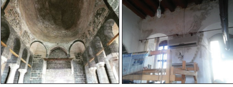
Şekil 8. Saint George ve Protestan Kiliselerinde neme bağlı oluşan hasarlar
