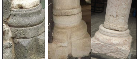
Şekil 6. Saint George ve Meryem Ana Kilisesi'nde meydana gelen eksen- aks kayması ve buna bağlı oluşan hasar örnekleri
