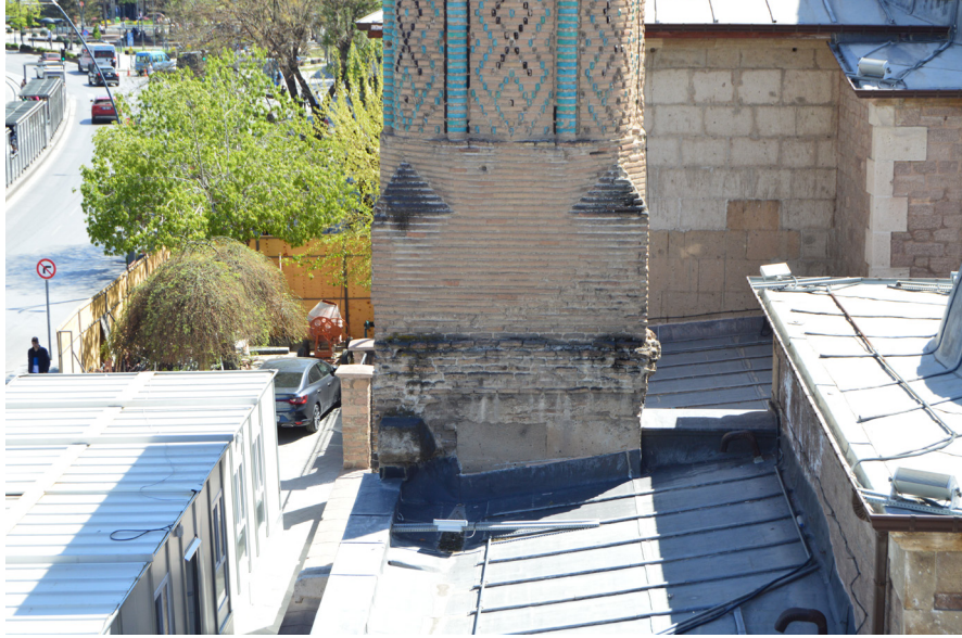
Fotoğraf 19: İnce Minareli Medrese-Minare kaidesinin kuzey cephesindeki tuğla kalıntıların durumu
