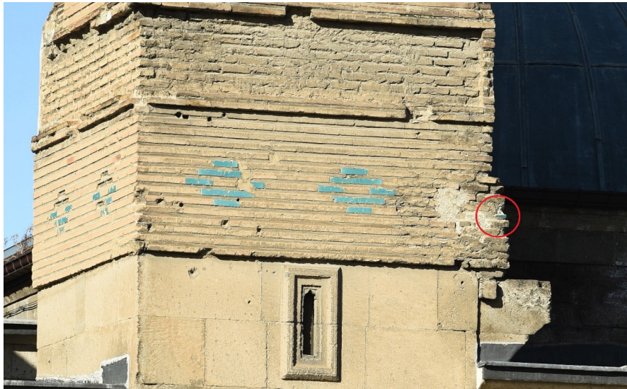
Fotoğraf 20: İnce Minareli Medrese-Minare kaidesinin doğu cephesindeki tuğla örgü arasında yer alan sırlı tuğla parçası ile altta kemer profilinin köşesindeki ahşap hatılın durumu
