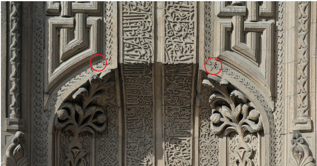
Fotoğraf 10: İnce Minareli Medrese Taçkapısı- Taşa Gömülü Demir Kenetler
