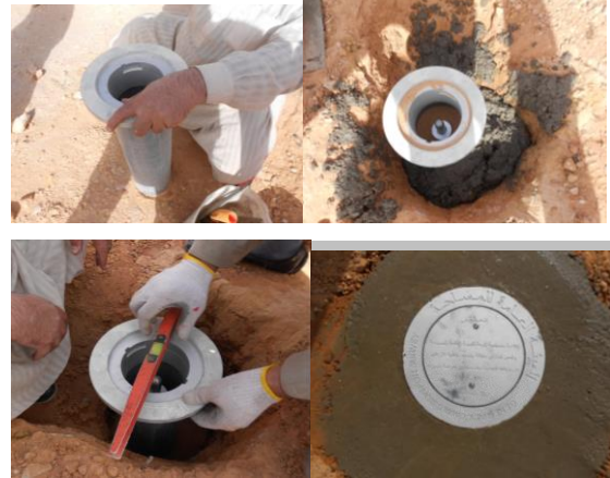
Şekil 7(a,b,c,d). Dış PVC borunun hazırlanması, Dış PVC borunun yerleştirilmesi, Tesis işleminin tamamlanması.
