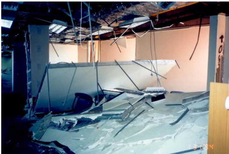
Şekil 3. Deprem sonrası devrilmiş bölme duvar
